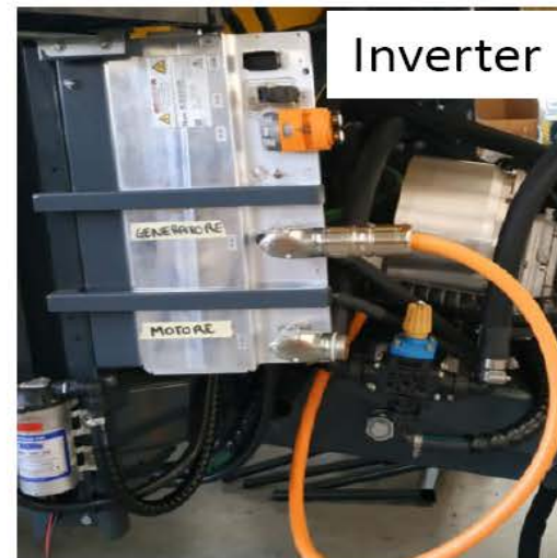
Inverter collegato in entrata al generatore ed in uscita al motore elettrico
